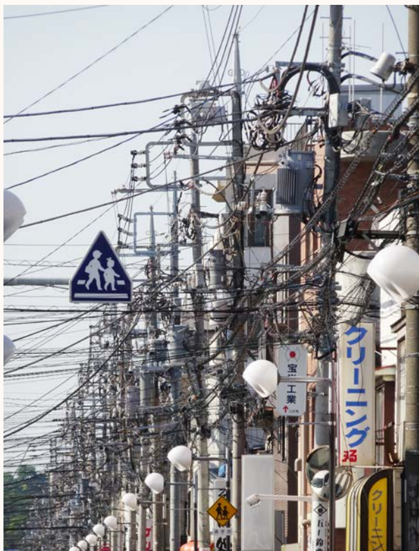
圖2:錯綜複雜的電線桿與電纜線
