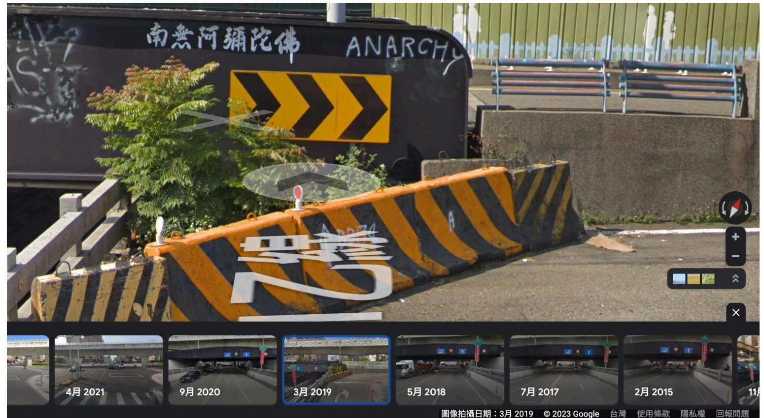
▲ 拆除前圖片：（鐵路已高架化，但地下道還未填平） 來源 | Google Maps
